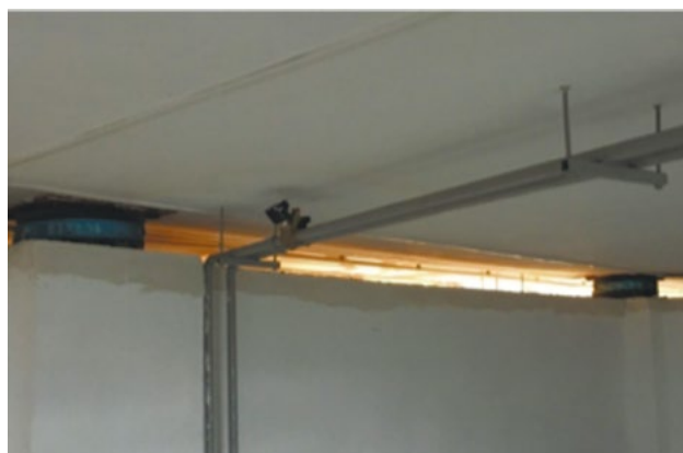
Рисунок 2 — Общий вид установленных резинометаллических опор
